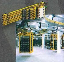
Schleifleitungen für Elektrohängebahnen
